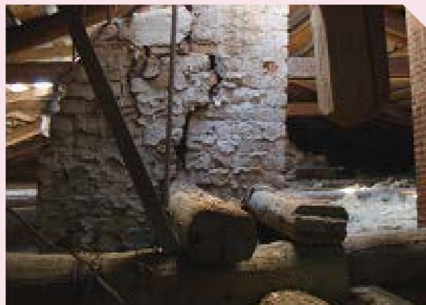
► Дом №29. Состояние печных труб до реставрации
