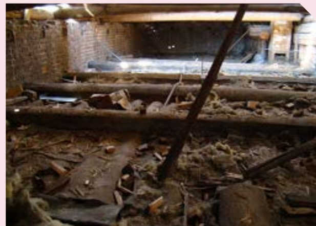
► Дом №29. Состояние перекрытия чердака до реставрации
